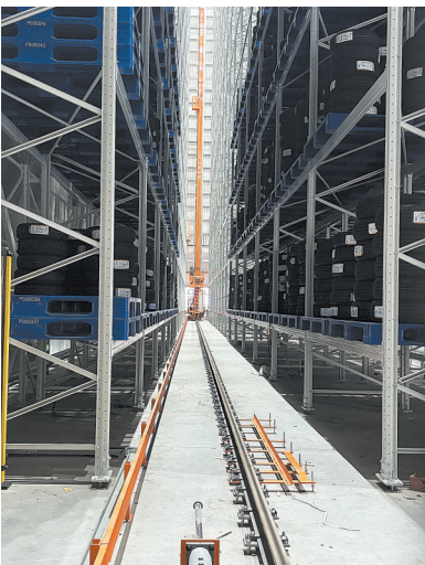
四川远星橡胶智慧云仓立体仓库。
