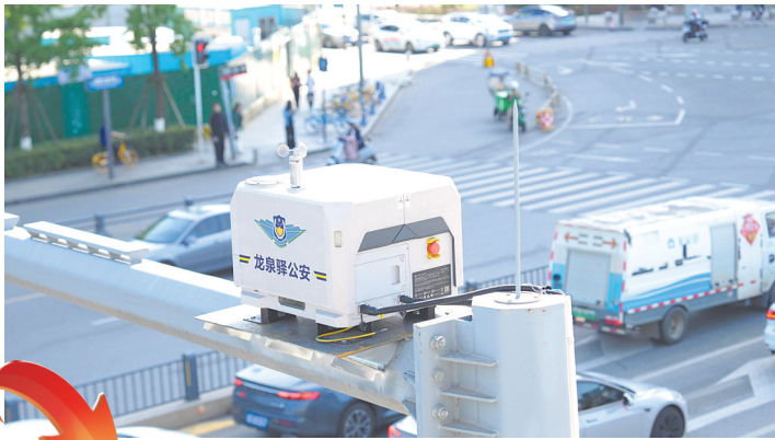
信号灯杆上建无人机“机库”。
