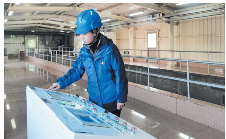
杜济伶在厂房巡视
