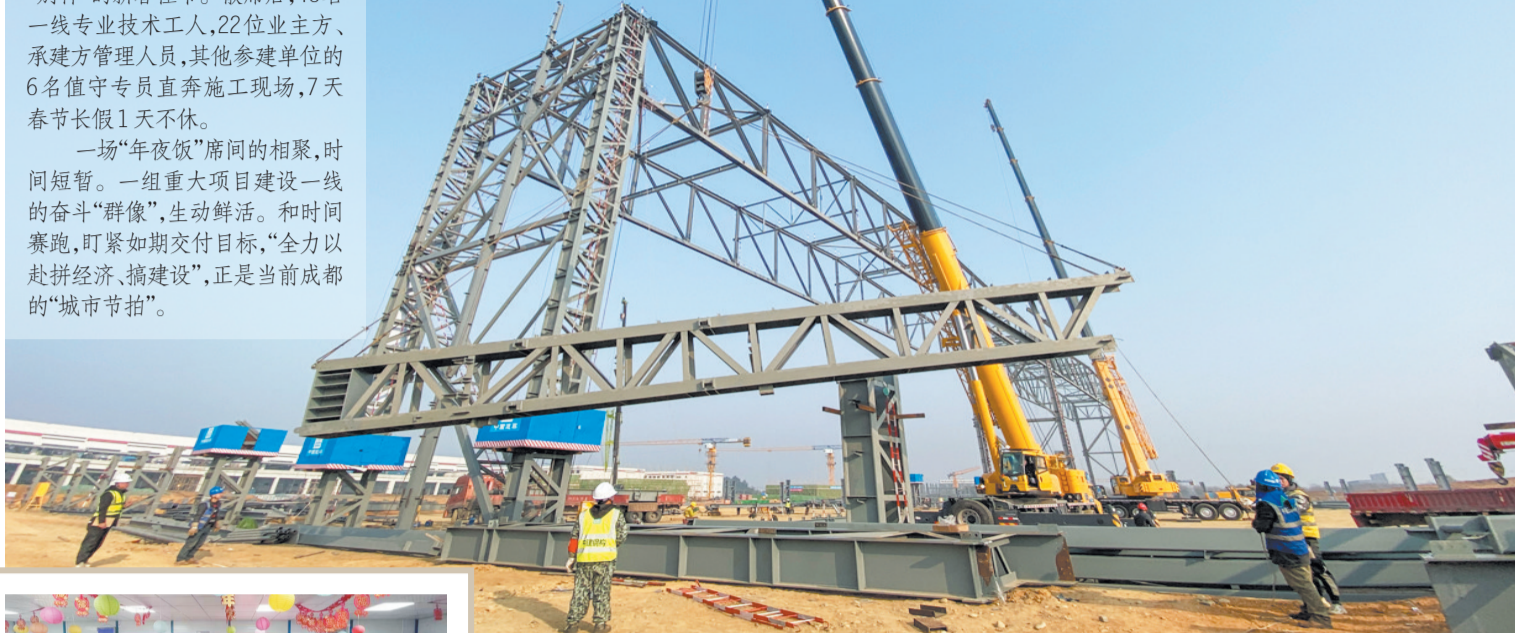
空客项目施工现场,工程设备正在吊装飞机库钢结构部件
