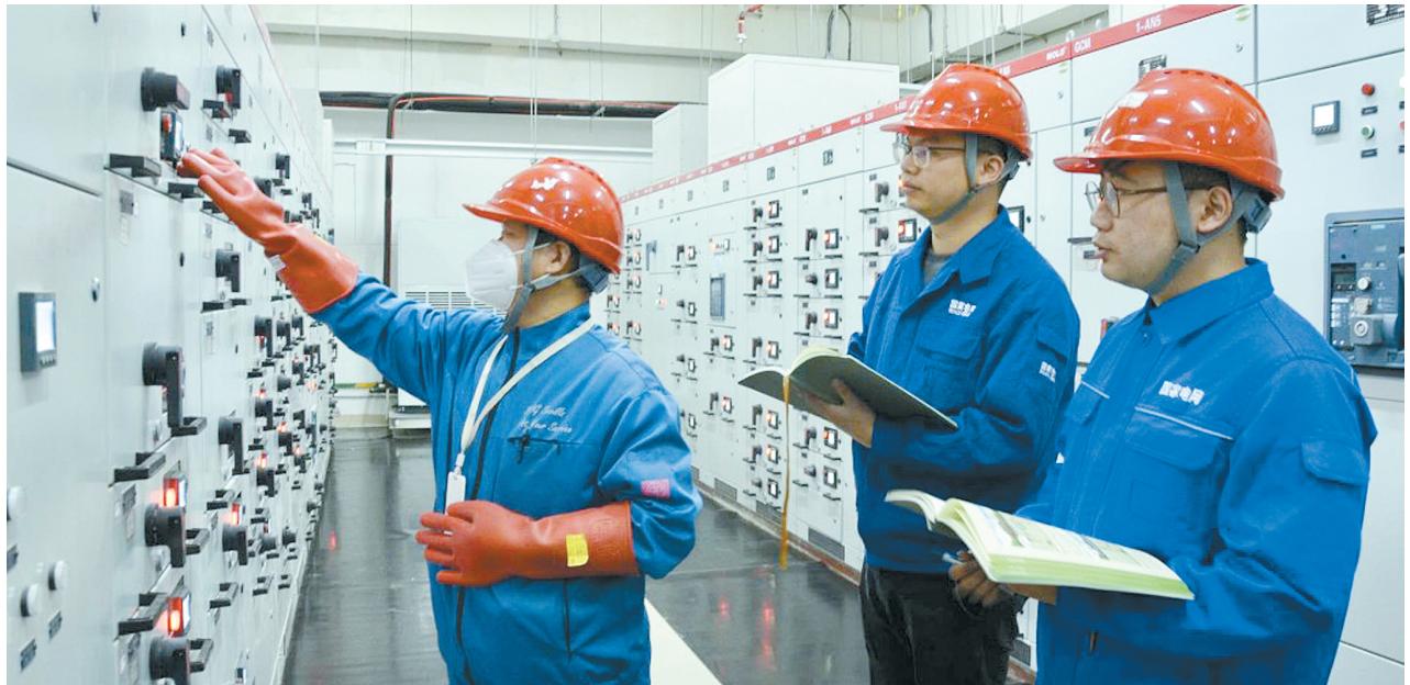
国网成都供电公司工作人员协助检查用电设备
