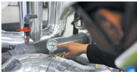
霍佳龙在游泳跳水馆水处理机房进行日常安全检查
