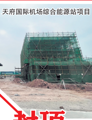
天府国际机场综合能源站项目
