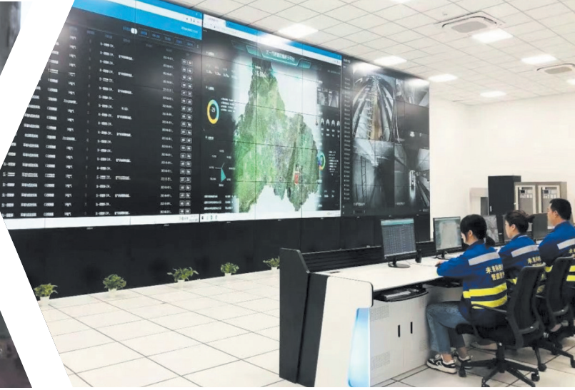
全覆盖、无死角地实时监控管廊运行情况
