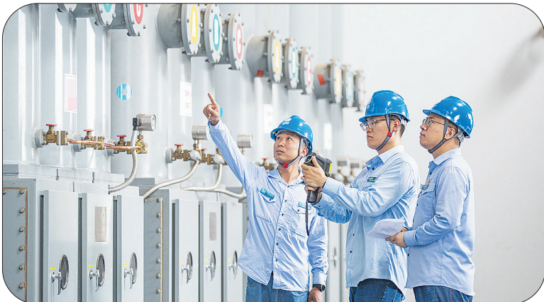
▲工作人员在220千伏某重点变电站对GIS设备进行红外测温
