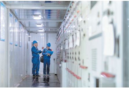
电力人员正在巡检配电设备
