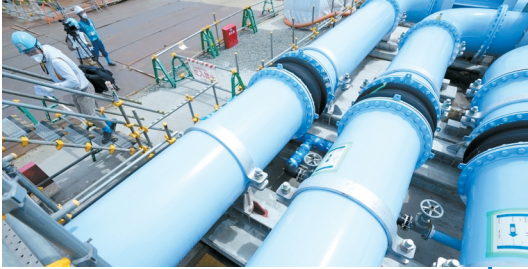
污水稀释排放设施中的海水输送管道
