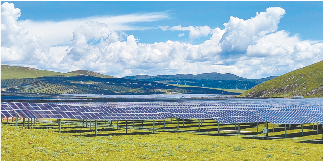
国家电投兴川实证光伏电站
