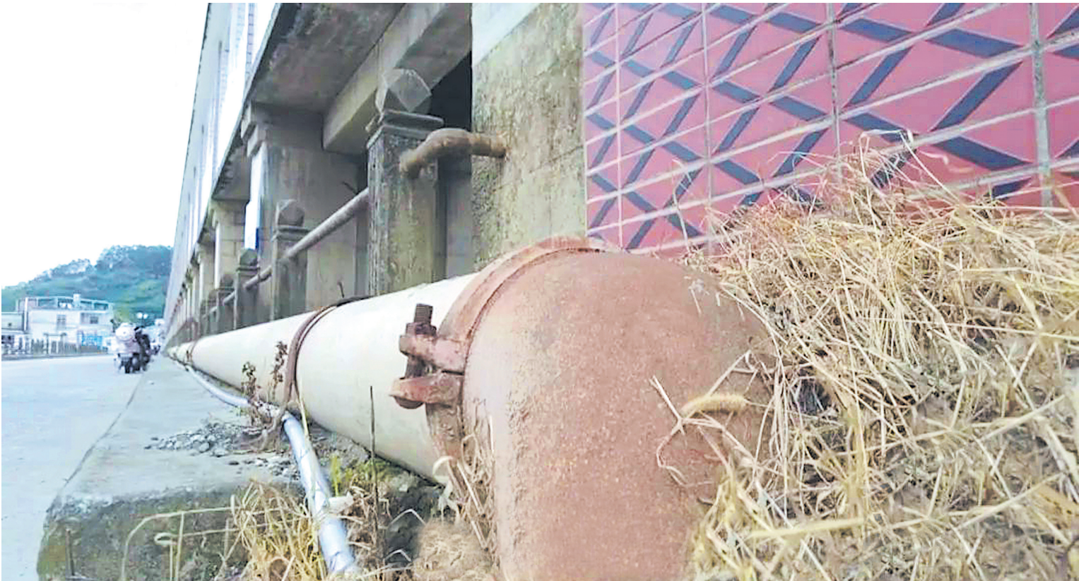
松浦村头的南溪桥上，水管弯头部位已经锈迹斑斑
