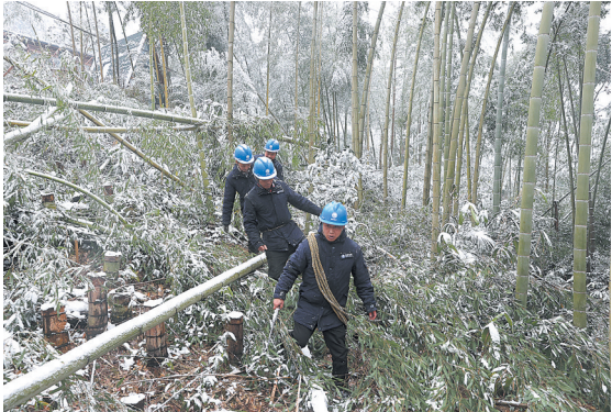
国网崇州供电公司工作人员对10千伏同坪线开展巡视工作
