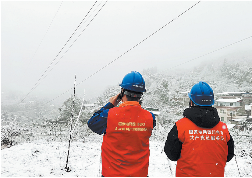
工作人员巡检铁塔和输电线路 图据国网成都供电公司
