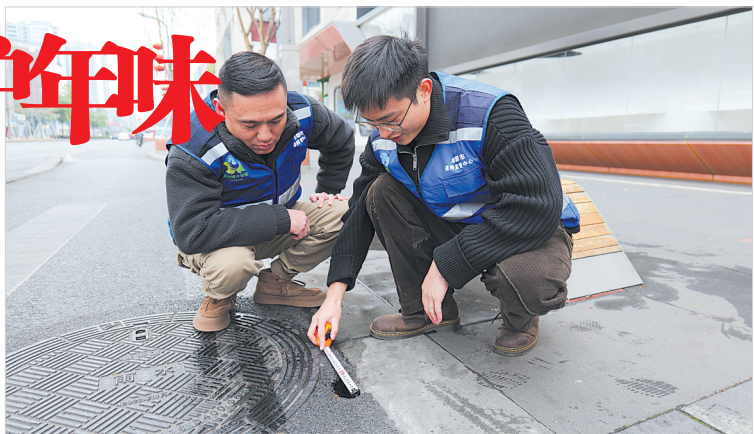
道路桥梁监管服务中心的工作人员正在测量路面上的窞坑 受访单位供图
