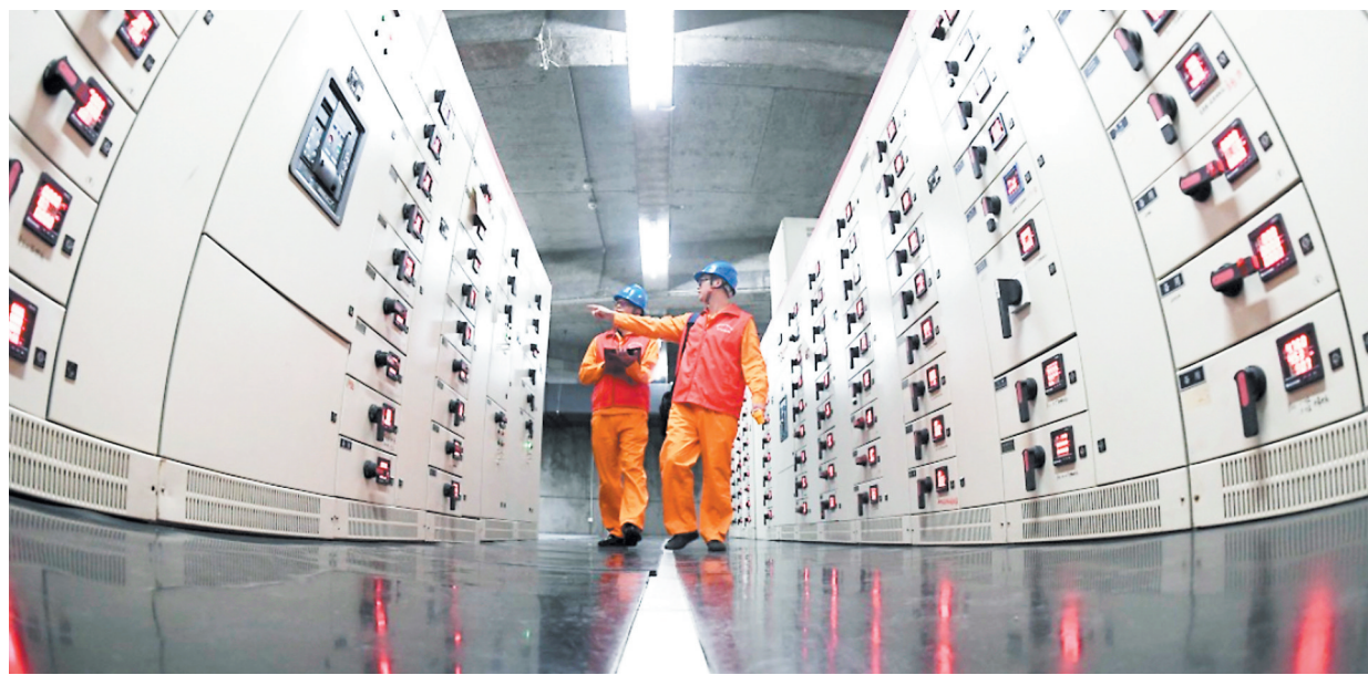
服务队在世纪城新国际会展中心一配电房巡视。
