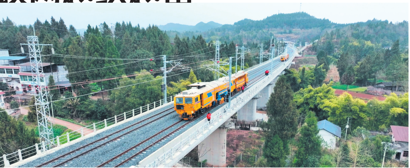
成都工务大机段职工正在指挥大机对巴南高铁进行精调捣固施工
