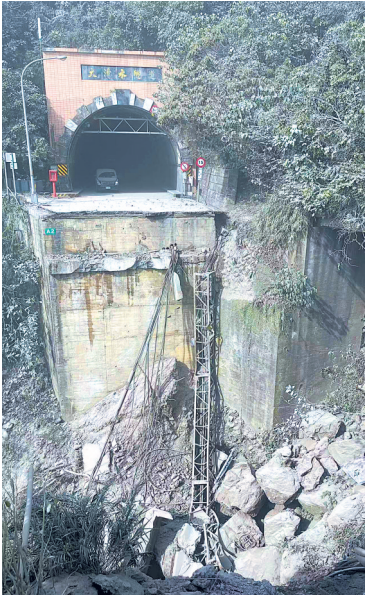
苏花公路大清水隧道外发生塌方
