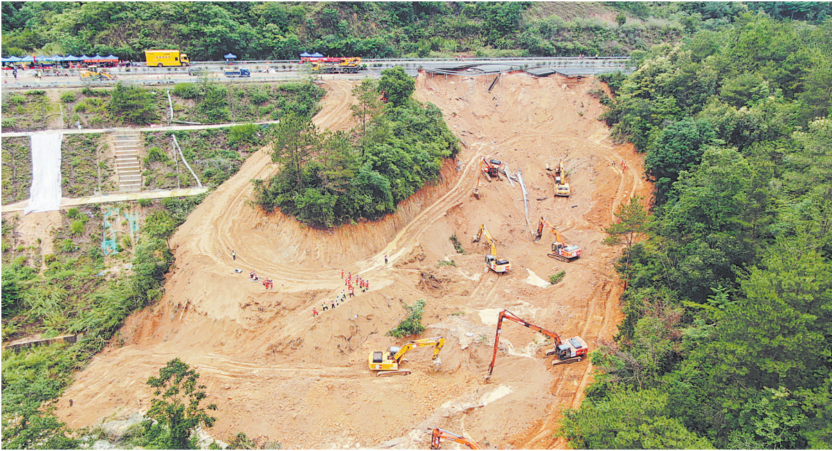
5月1日，救援力量在塌方灾害现场作业。
