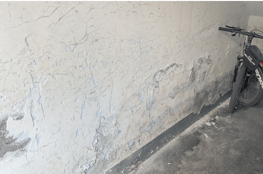
水管破裂处在单元楼道旁的墙体里，给维修带来不便
