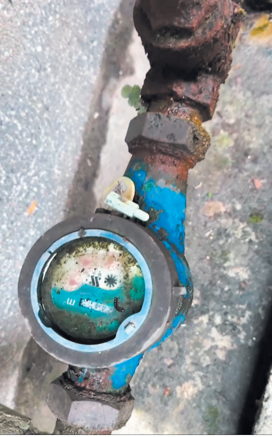
裸露在外的水表已锈迹斑斑
