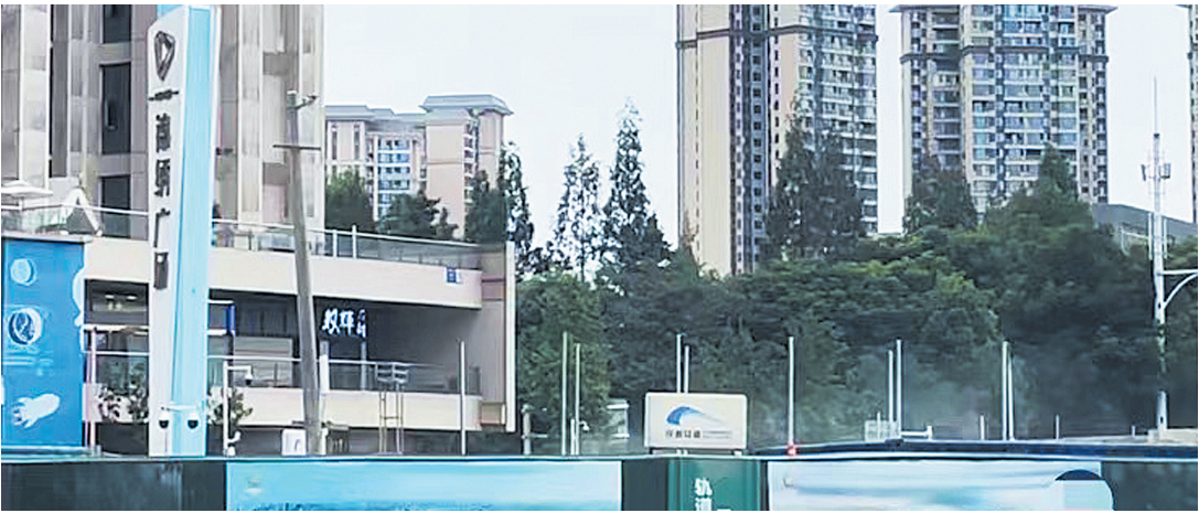
工地围挡上，喷淋系统并没有开启
