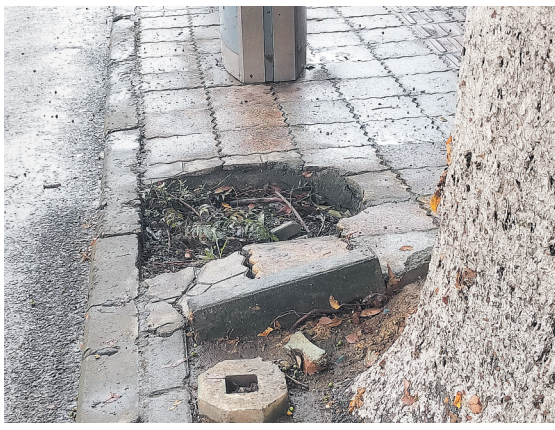
成华大道龙潭段路面破损。 本报资料图片
