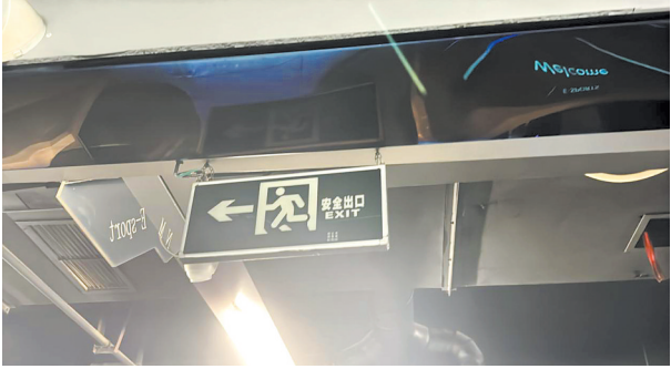
网吧内一处疏散指示灯处于熄灭状态。
