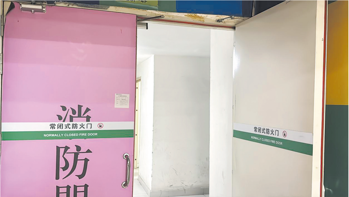
商场内常闭式防火门未能保持关闭。
