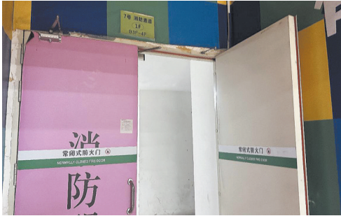
商场部分常闭式防火门依然处于打开状态。
