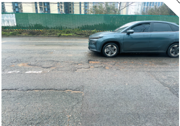
路面破损情况较严重。
